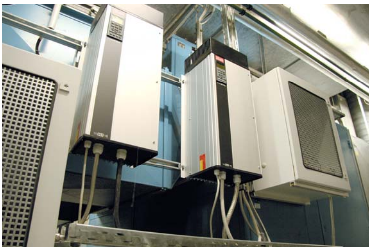
Einsatz von Frequenzumformern für energieeffiziente Lüftungsanlagen
